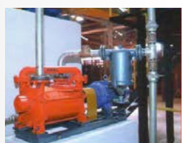
Bomba de vacío
