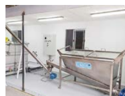
Equipos de floculación
